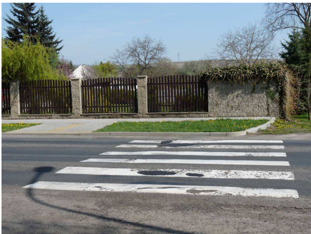
Obr.25 Špatně zasazený přechod pro chodce, nenavazující na chodník
