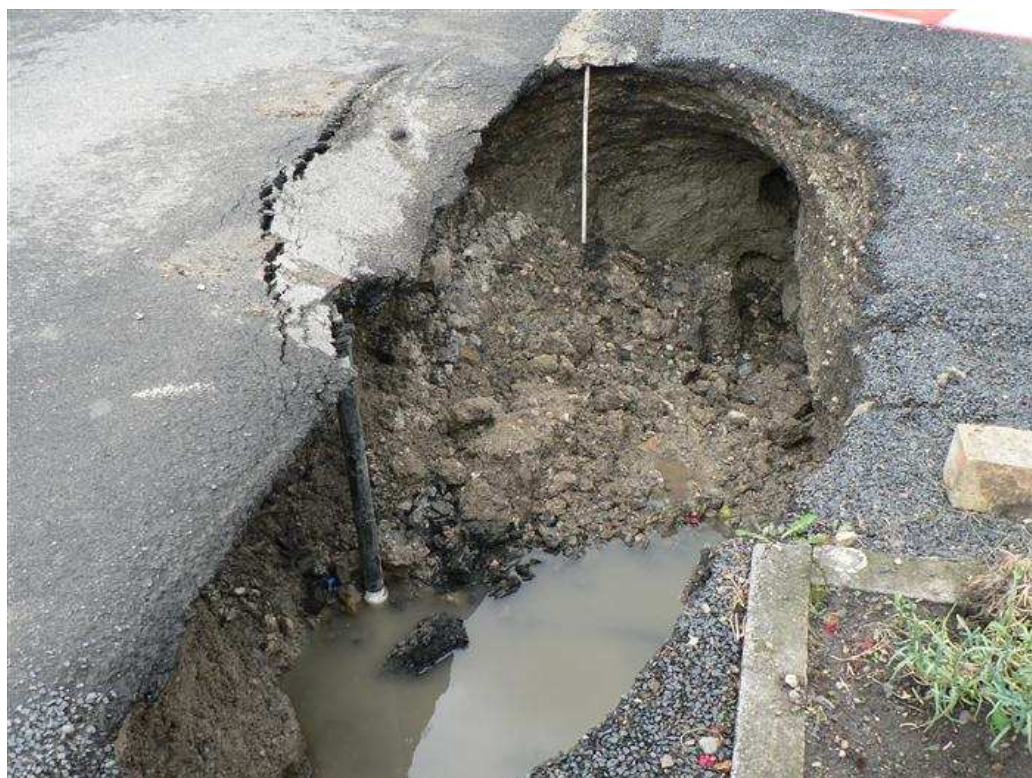
Obr.29 Propad kanalizace v ulici Na Vinici (2009)
