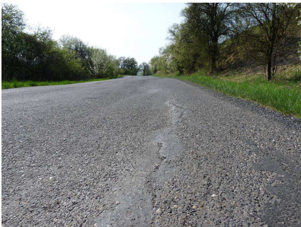
Obr.23 Oblast sesuvu půdy i se silnicí III.třídy směr Vojnice
