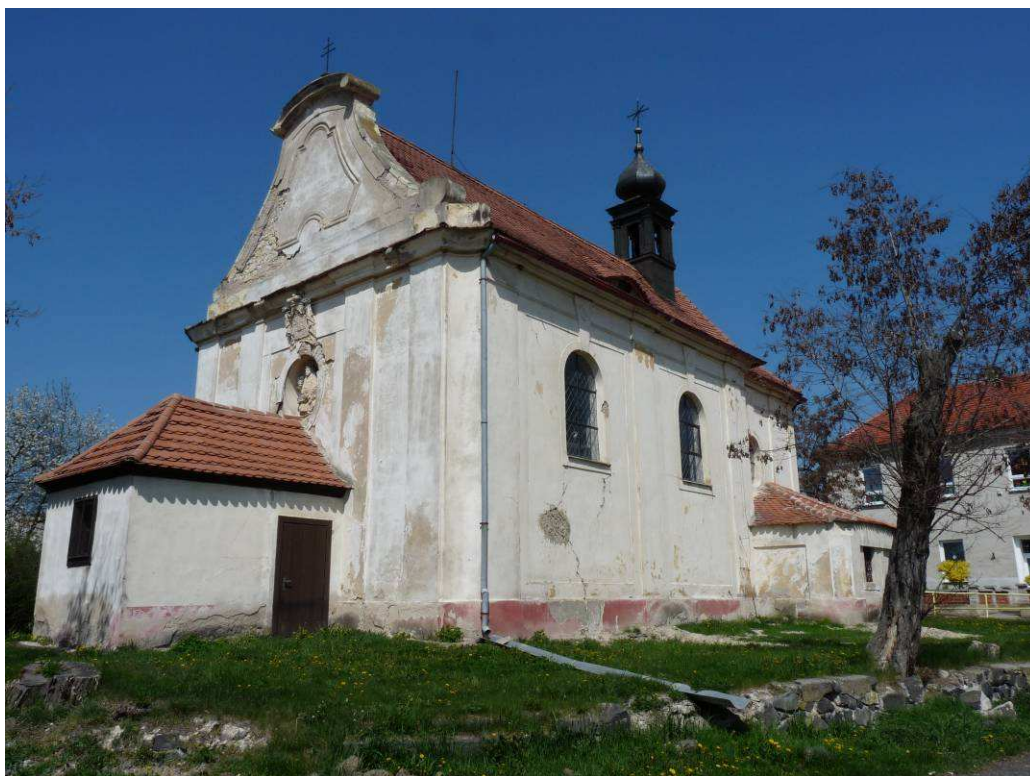
Obr.7 Kostel sv. Antonína Paduánského v současném katastrofálním stavu
